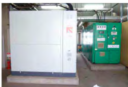
バイオガス専焼発電機
