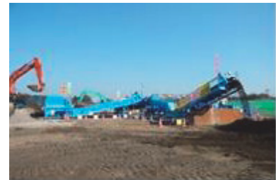
万能土質改良システム 全景
