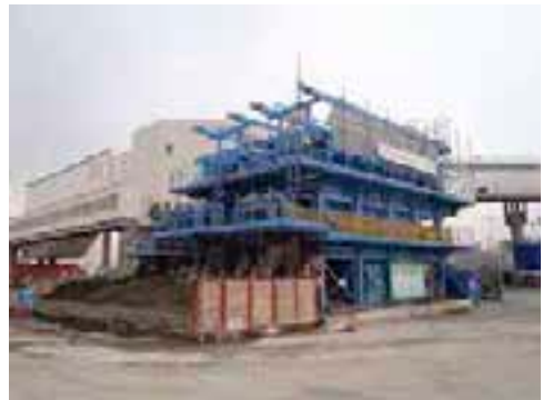
排泥処理プラント
