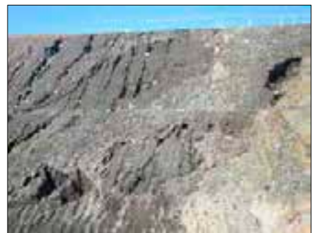
法面の浸食状況
