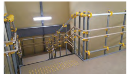
仮設部材を使用した手摺
