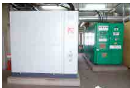
バイオガス専焼発電機
