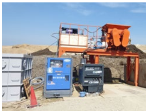
生育基盤材製造小型プラント
